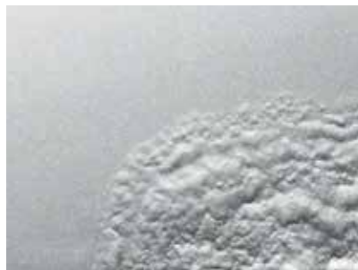
Eau de condensation / corrosion
